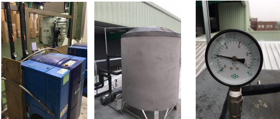
圖四、熱回收完工設備
